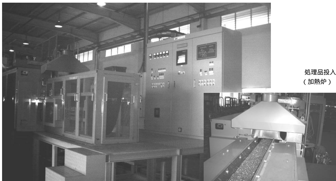
増設した精密用・連続熱処理炉。写真は加熱炉の投入口・操作盤
