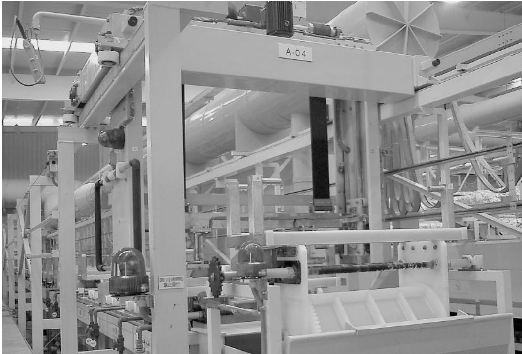
コンピュータ制御による完全自動化の3価クロム専用電気亜鉛めっきライン
