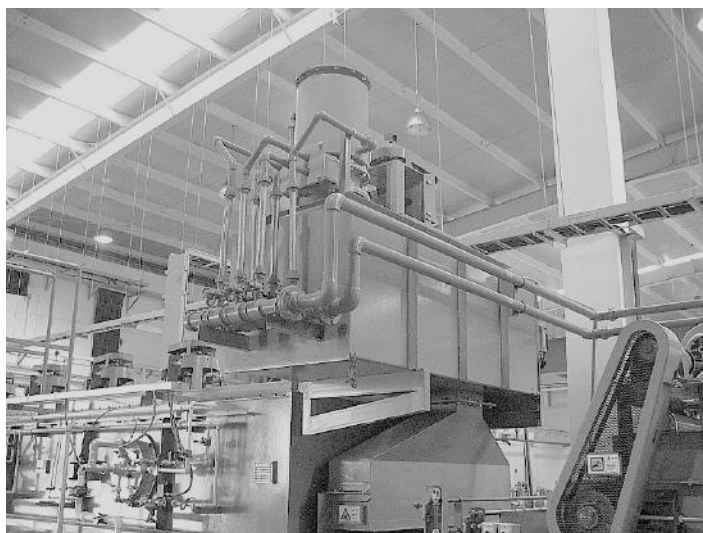
消煙装置 焼炭炉前の油煙を燃焼させ，排ガスを中間洗浄シャワの加熱源として再利用
